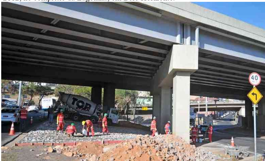
Figura 3 - Instalação de pedras pontiagudas sob o Viaduto Nansen Araújo em 2012, no complexo da Lagoinha, em Belo Horizonte.
